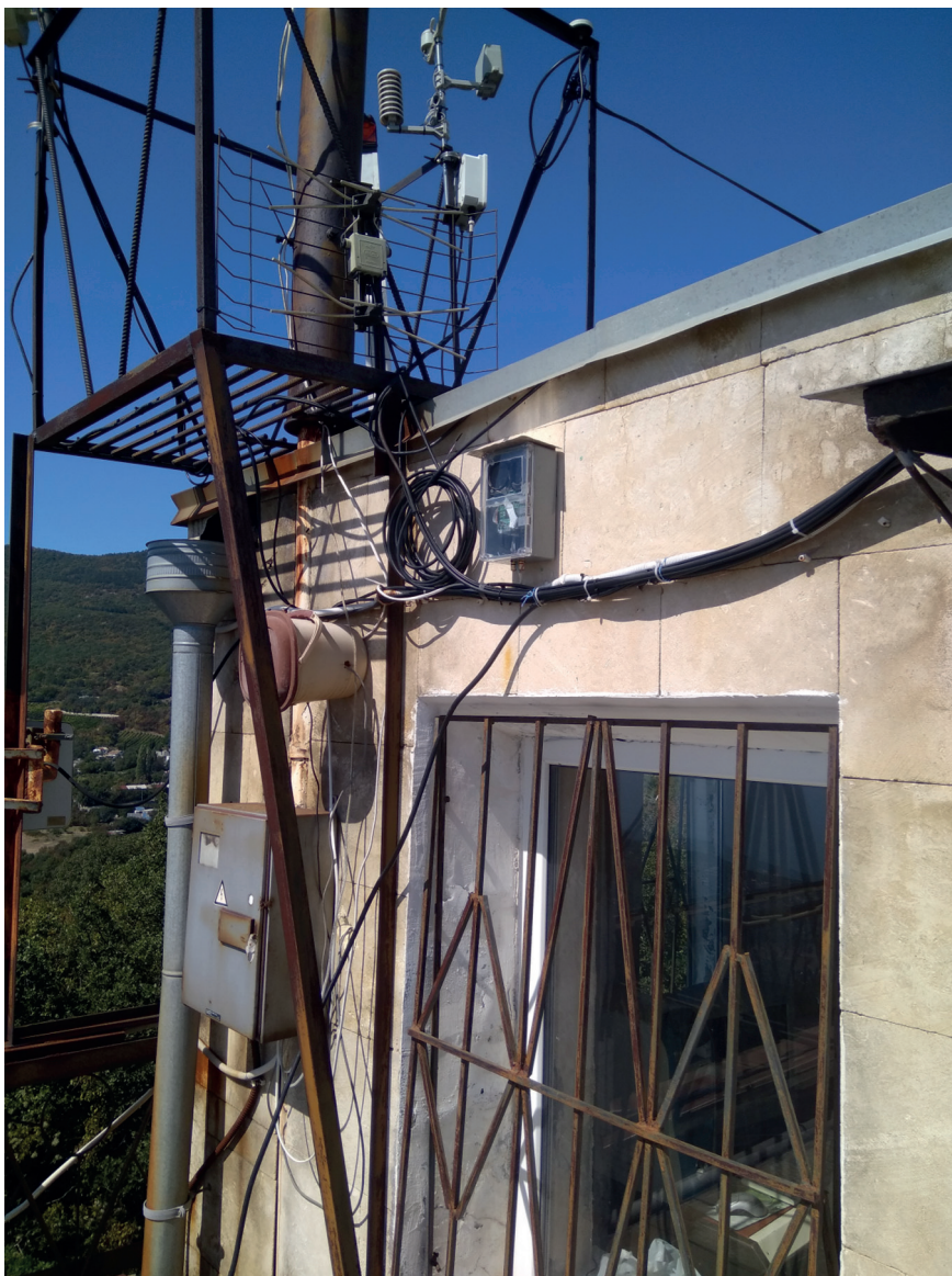
Рис. 2. Аппаратура, установленная на обсерватории
