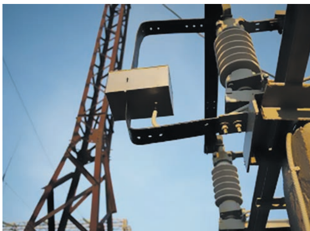
рис. 4. Регистратор, закрепленный на заземляющей шине. Подстанция в г. Кондопога.
