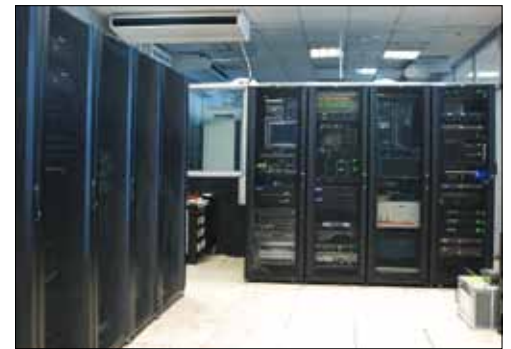
Стойки с серверами. Машинный зал Racks with servers. Computer room
